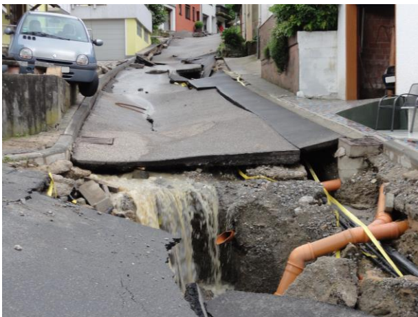
Bild 1: Starkregenschäden in Billigheim-Allfeld (30.05.2016)
